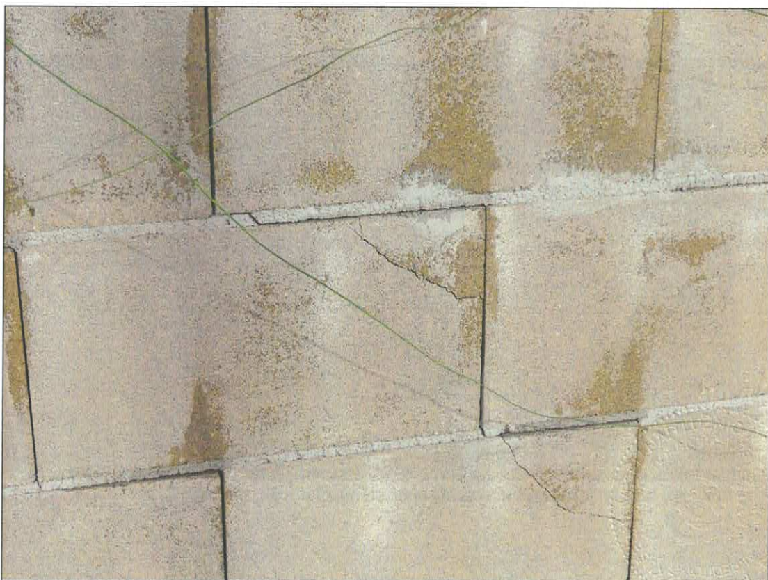
Trhlinky a spáry v dolním levém rohu – 16. minuta
